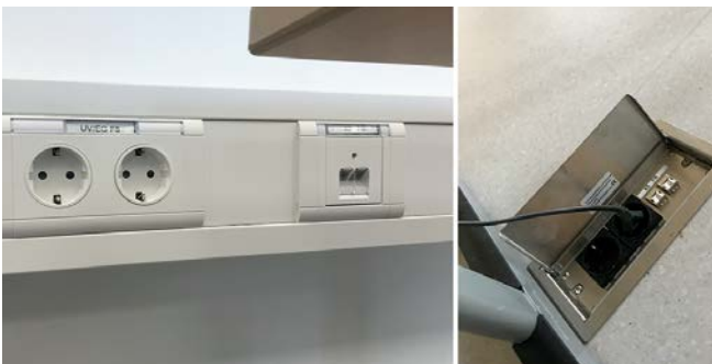
Bild 5: Bodentanks und Anschlüsse
